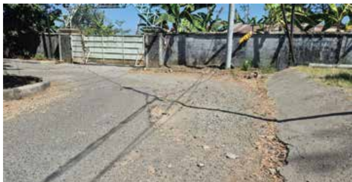
Kondisi Jalan Gerbang Belakang Kampus 1 PNUP. [SA/476]
