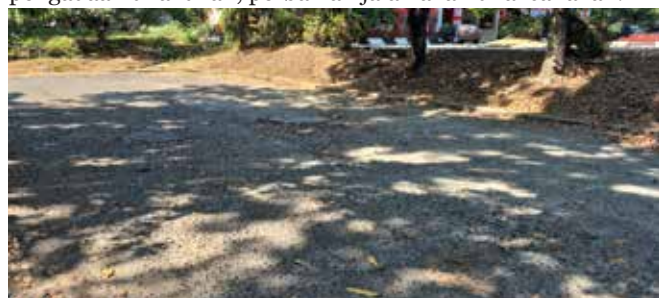
Kondisi Jalan Dekat Gedung Direktorat Kampus 1 PNUP. [SA/476]
